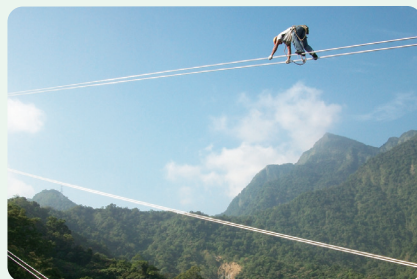
輸電線路工程
